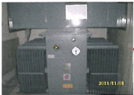
高效能變壓器 11.4kv→22.8kv
